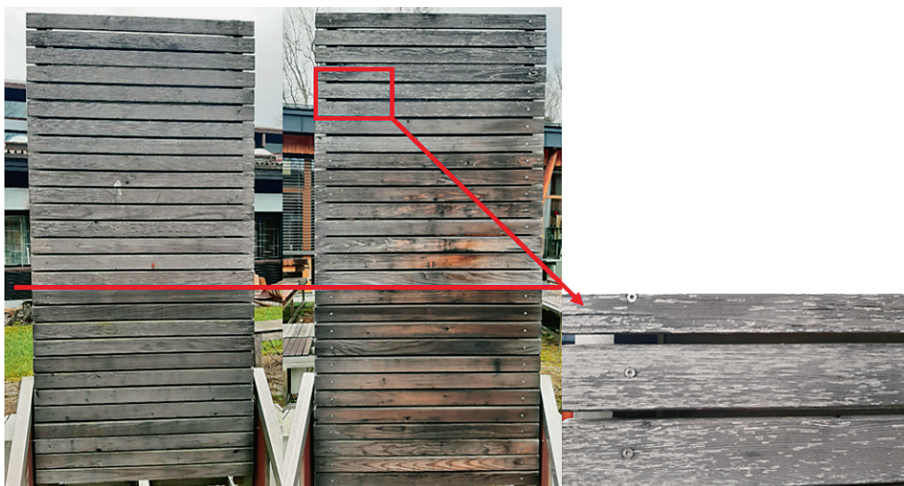
Figure 1 Model façades exposed outdoors for 5 years. Above red line control samples, below iron (II) sulphate treated wood. Left façade exposed to nord, right façade exposed to south. Surface damage by wasps is clearly visible on control samples. Slika 1. Modeli fasada pet godina izloženih vanjskim utjecajima. Iznad crvene crte nalaze se kontrolni uzorci, a ispod nje je drvo tretirano željezovim (II) sulfatom. Lijeva fasada bila je izložena prema sjeveru, a desna prema jugu. Na kontrolnim su uzorcima jasno vidljiva oštećenja površine, uzrokovane osama.
