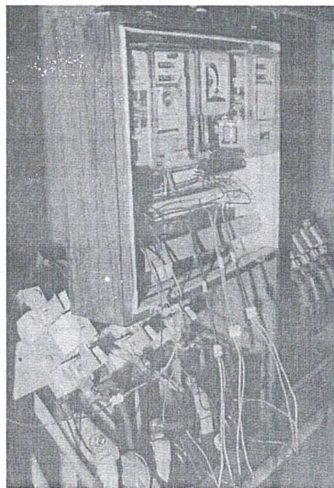
Slika 2. Priključeno električno brojilo u transformatorskoj stanici
